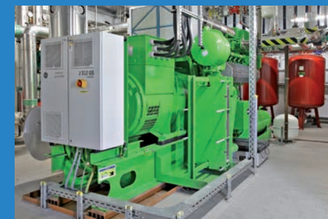
Mittels eines Gasmotors wird Strom mit diesem Gas erzeugt (jährlich rund 3.700 Megawatt).
